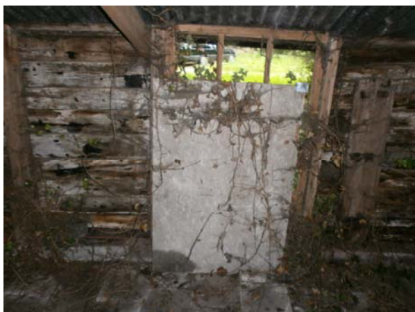
Foto 1 Losse plaat binnenzijde aanbouw
